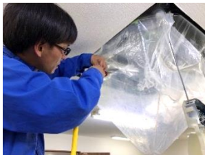
エアコン分解洗浄
