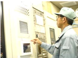
設備運転管理
