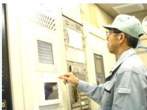
設備運転管理
