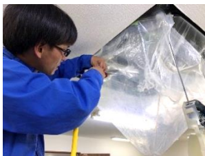
エアコン分解洗浄
