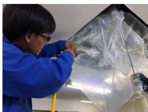
エアコン分解洗浄
