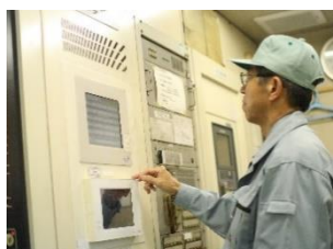
設備運転管理
